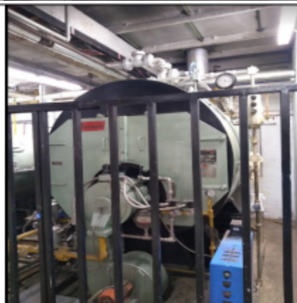
FOTO N°. 3 CALDERA DE 100 BHP
