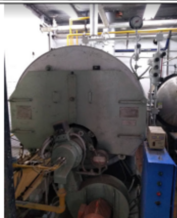
FOTO N°. 4 CALDERA DE 60 BHP
